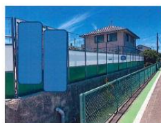
現場正面 オリジナルフェンス状況 若干の傾きあり、パトロール修繕にて修正済み
