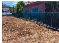
ネットフェンス状況 地盤が狭くポイント毎に太い杭施工 されていましたがもう少し太い杭あるとよかった
